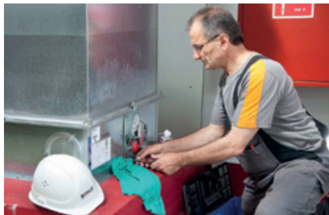
Wartung einer Brandschutzklappe
