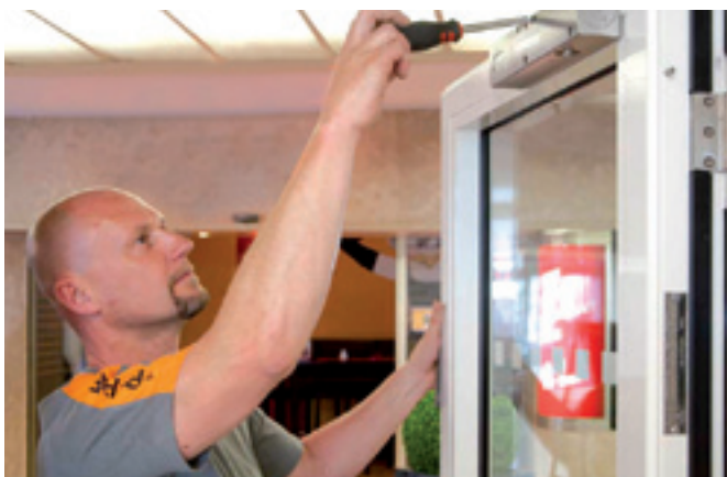
Wartung einer Feststellanlage
