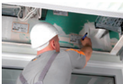
Brandschott im Deckenhohlraum über einer Feuerschutztür
