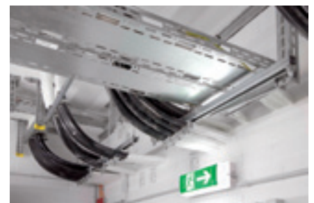
S 90 Kabelabschottung im Kraftwerksbereich
