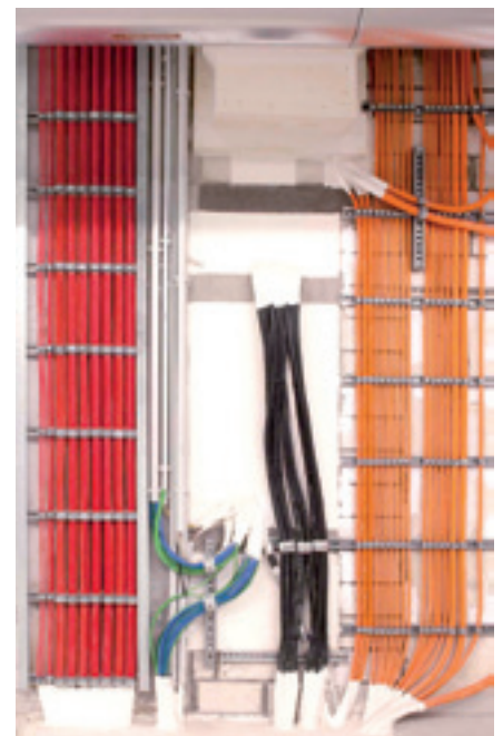
S 90 Kabelabschottung im Deckenbereich
