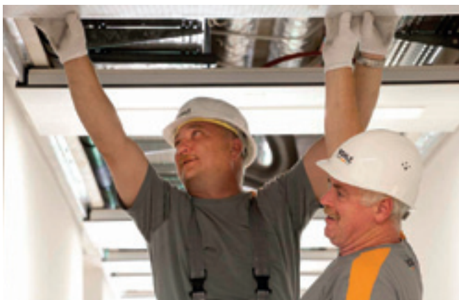
Wartung einer Brandschutzdecke
