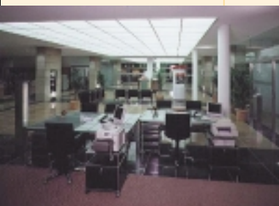
FORUM-Lichtdecke mit wassergekühlten Aluminiumprofilen, im SB-Bereich der Sparkasse Trier, Geschäftsstelle Simeonstraße
