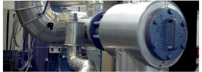
Mit PUR-Ortschaum und Alublech gedämmter Kühlwassersatz
