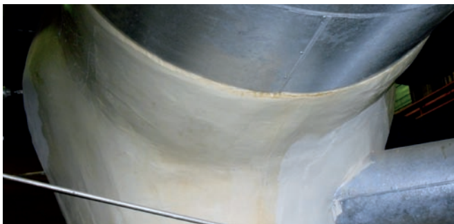
Detailansicht einer Spritzisolierung eines Schnellverschlussventils
