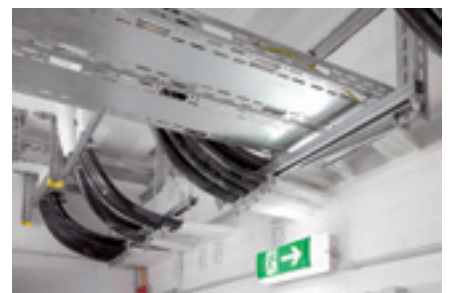
S 90 Kabelabschottung im Kraftwerksbereich
