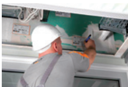
Brandschott im Deckenhohlraum über einer Feuerschutztür
