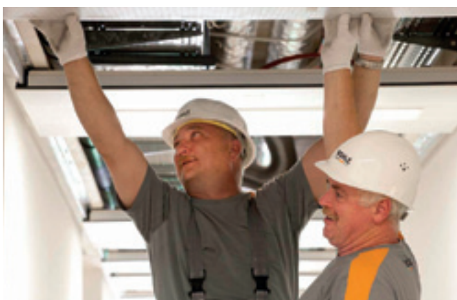
Wartung einer Brandschutzdecke
