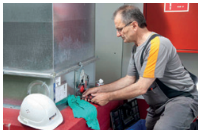
Wartung einer Brandschutzklappe
